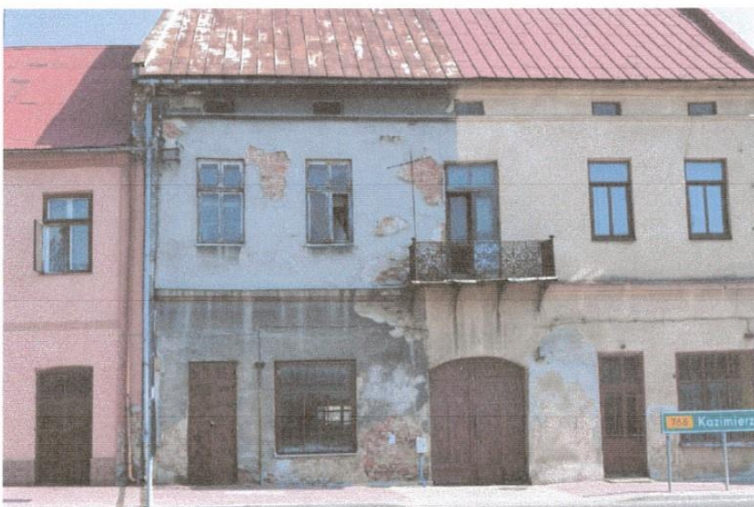
Zdjęcie 10. Stan niektórych budynków w Działoszycach
